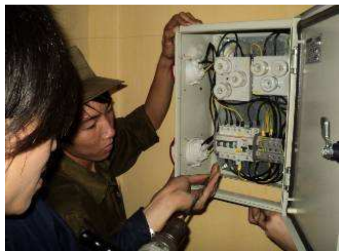
Foto 25. Und jetzt schliessen die Lehrlinge den neuen, selbstgemachten El. Schrank hinter den beiden Maschinen an. Eingang haben wir 100 Amp. Wir sichern mal mit 2 x 35 Amp. ab.
