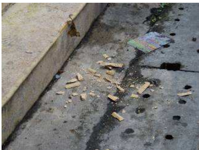
Foto 12 .... und hopp die Treppe ist beschädigt.
