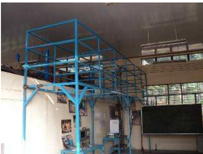
Foto 47: Das sollte das neue Dokumenten Gestell sein. Leider müssen wir es nach dem Urlaub noch einmal demontieren. Es muss anderst gemacht werden. Wir wollen, dass die Zeichnungen zum Genehmigen gesandt werden.
