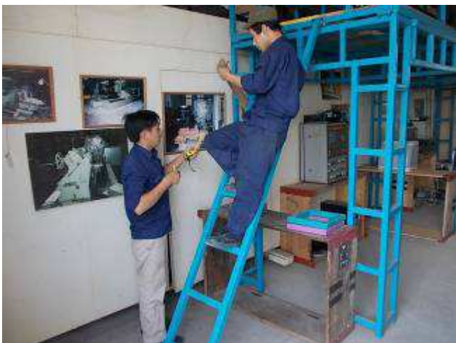
Photo 28: Diese Treppe hat kein Handlauf. Der wird nun skizziert.
