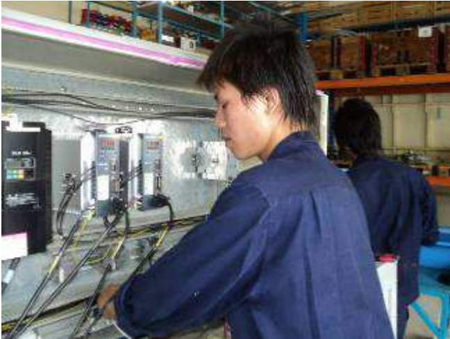
Photo 33: Es ist zwar immer noch derselbe Elektro Schrank, doch den müssen sie im Kopf speichern, damit sie genau wissen, was und wie und wo.
