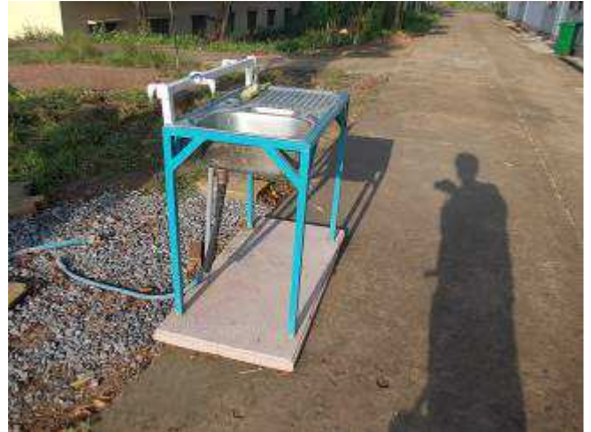
Foto 3: Jetzt müssen die Lehrlinge nicht mehr am Boden die Hände waschen. 4 Wasserhähnen stehen ihnen zur Verfügung.
