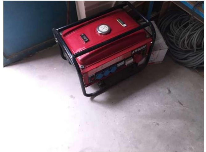
Damit wenigsten der Theoriebetrieb weiter geführt werden kann, wenn in Vietnam während der Trockenzeit die Stromversorgung gebietsweise abgestellt wird, ist ein Generator eine gute Sache. Der 400 Volt Generator wurde aus der Schweiz mitgebracht und kann auch für das Bohren verwendet werden. Raum 1b. Foto WS10_590
