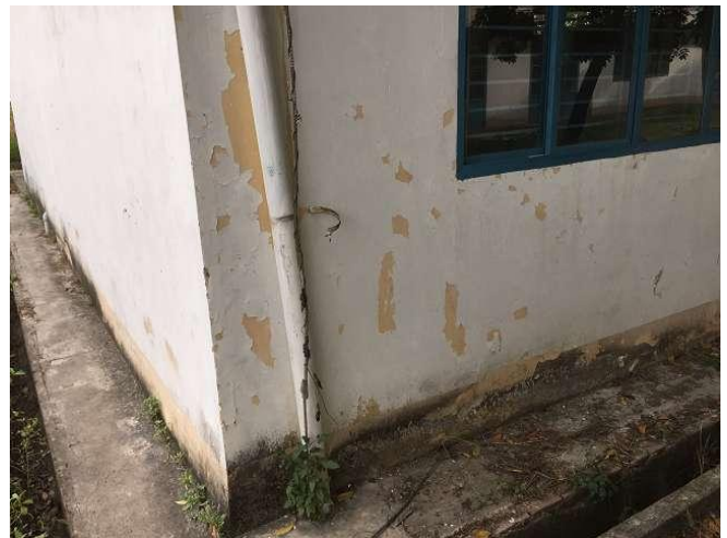
Die ganzen Fassaden der Schule wurden vor etwa 3 Jahren neu gemalt. Die Kosten haben wir mit der Schule halbiert. Warum sehen in Vietnam Gebäude in Kürze wieder so aus? Ist es die Qualität der Arbeit? Oder des Materials? Ort: Aussenansicht Raum 3b. Foto WS10_330
