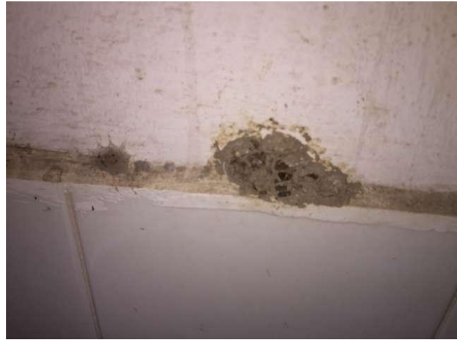
Wespennester im WC. Ort: WC hinter dem Raum 6. Foto WS10_320
