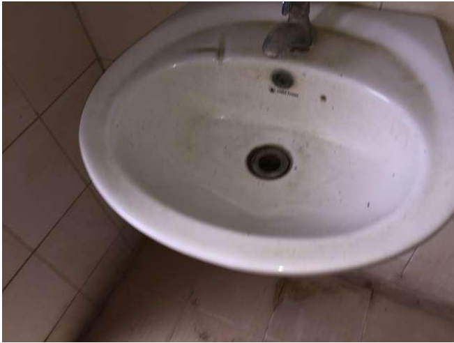
Warum wird nie geputzt? Ort: WC hinter dem Raum 6. Foto WS10_290
