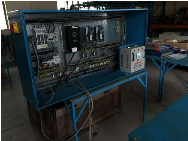
Das ist der Elektroschrank der Wiap DM2S. Motoren alles ist hier. Doch auch hier sind wir in der Prüfphase, ob nicht wir alles mit den neusten Siemens Produkten machen sollen, damit die Instrukoren Stand der Technik der nächsten Generation lernen können. Raum 5. Foto WS10_585
