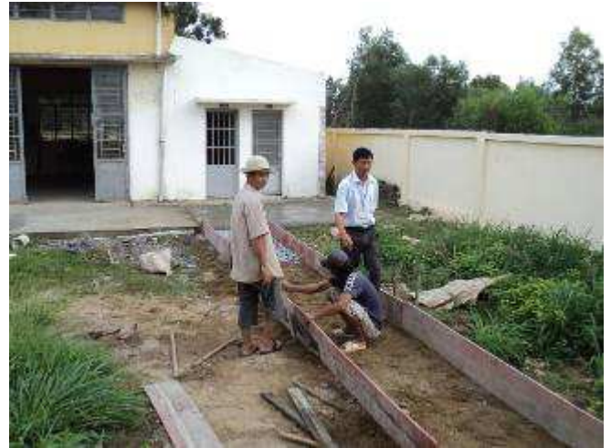
Photo 13: Weil unser Elektroraum Nr. 6 die Strasse nicht hatte, hat man diese noch ergänzt, damit man überall mit dem Paletwagen hin- und herfahren kann. Unseren Weg rüber zu den anderen Räumen und zur Toilette liessen wir jetzt auch gleich noch machen.
