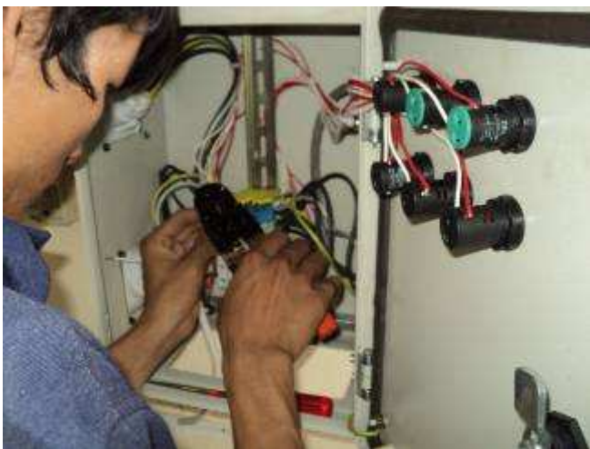
Photo 17. Hier verdrahtet ein Lehrling noch das Stromzuführpanel fertig , so dass wir bald den Testlauf beginnen können.
