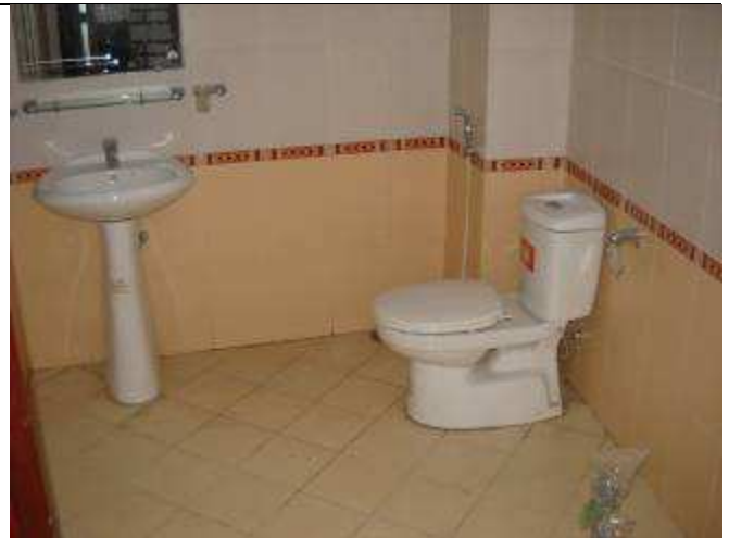
P22: So WC wo man gleich duschen kann, Armaturen u.s.w ist etwas nach zu bessern
